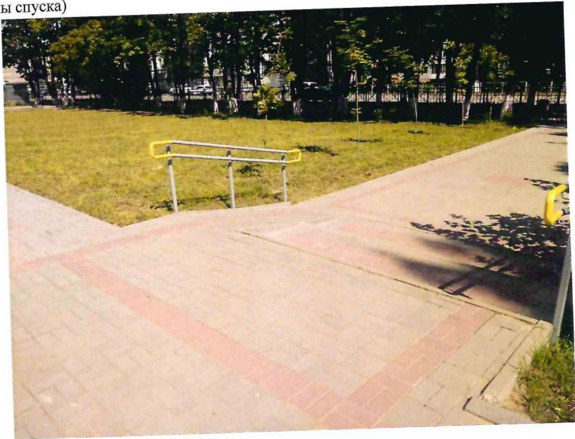
Фото 4. Перепад высотных отметок дорожного покрытия на подходе к зданию школы (вид со стороны подъема)
